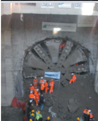
In alto, utilizzo dell'idrofresa per la realizzazione dei diaframmi delle stazioni. Al centro, stazione terminata al rustico. Sopra, uscita della EPB-TBM in una delle 15 stazioni di linea. Sotto, plastico della stazione tipo (Arch. Bernard Kohn).
