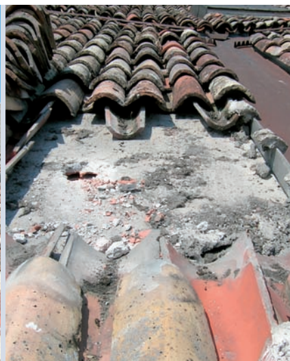
Al centro, tetto, visione frontale: si intuisce dalle differenti inclinazioni, che il tetto ha subito ampliamenti in epoche diverse.
