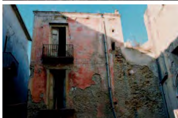
Danneggiamenti e deterioramento delle pareti murarie.
