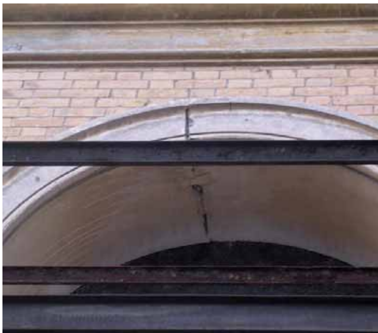
Nell'immagine, il degrado della lunetta di un edificio.
