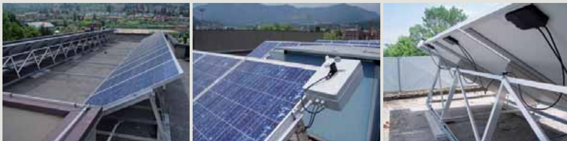
L'impianto delle scuole elementari prevede una potenza nominale di 18,90 kW, mediante l'uso di 90 moduli da 210 Wp e di 3 inverter Conergy WR5900E. Sono stati utilizzati 90 moduli Conergy SCM 210 in silicio policristallino di potenza nominale 210 Wp, suddivisi in 9 stringhe. I moduli si trovano ad operare in condizioni ideali: l'inclinazione a 30° e l'orientamento SUD -6° (sud-sud-est) si sposano con le caratteristiche climatiche della zona, battuta dal sole e da un vento costante che permette un buon raffreddamento della superficie per quasi tutto l'anno. La stabilità statica dell'impianto è stata ulteriormente aumentata utilizzando barre supplementari e ancoraggi al muretto perimetrale: in questo modo si è creato un unico grande sistema di fissaggio che con la sua inerzia assicura un'alta resistenza ai carichi di vento.
