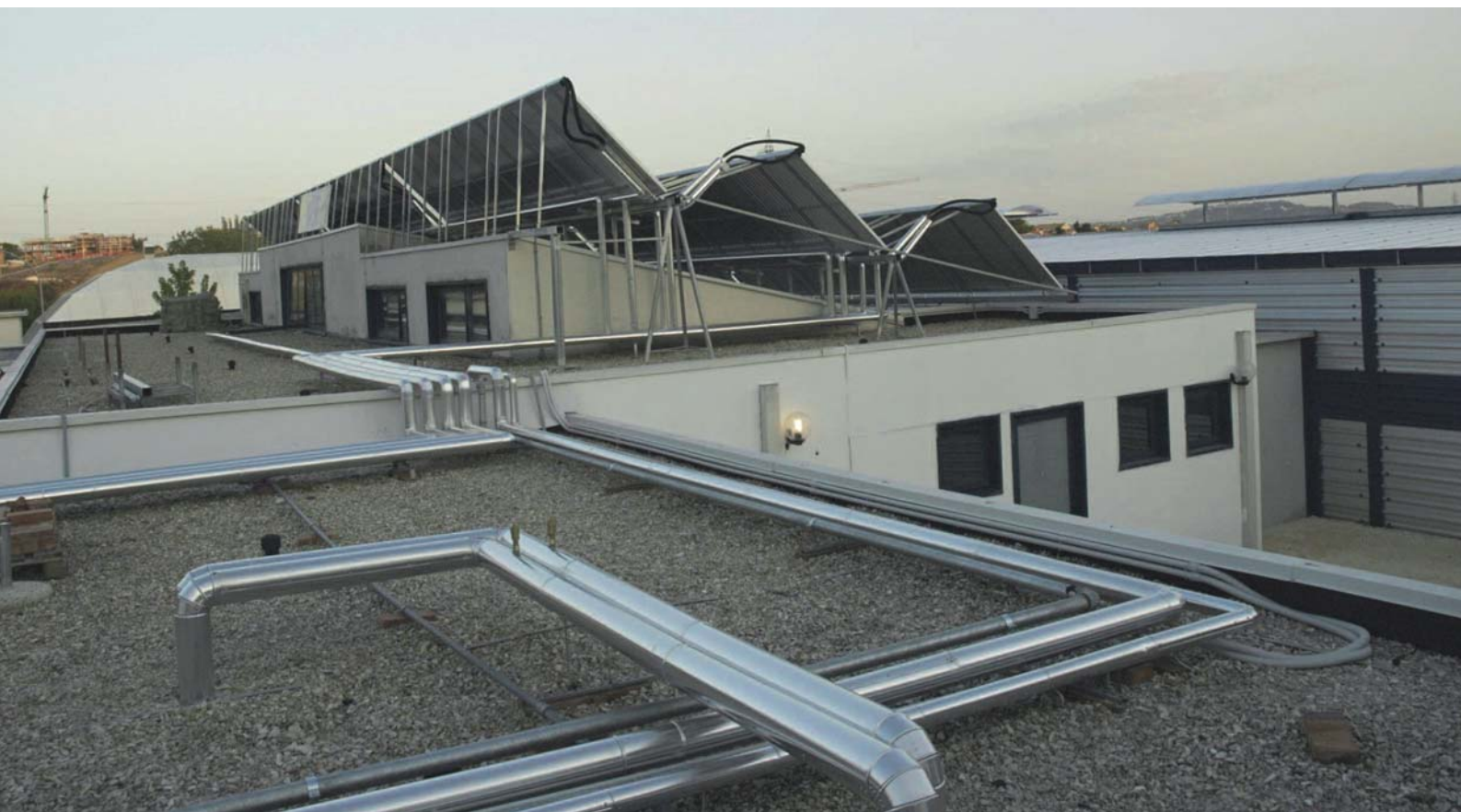
Vista dei collettori in copertura.
