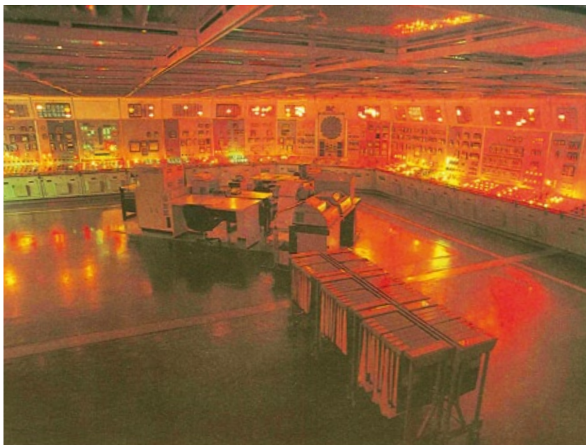
Sala di controllo della centrale nucleare di Caorso.
