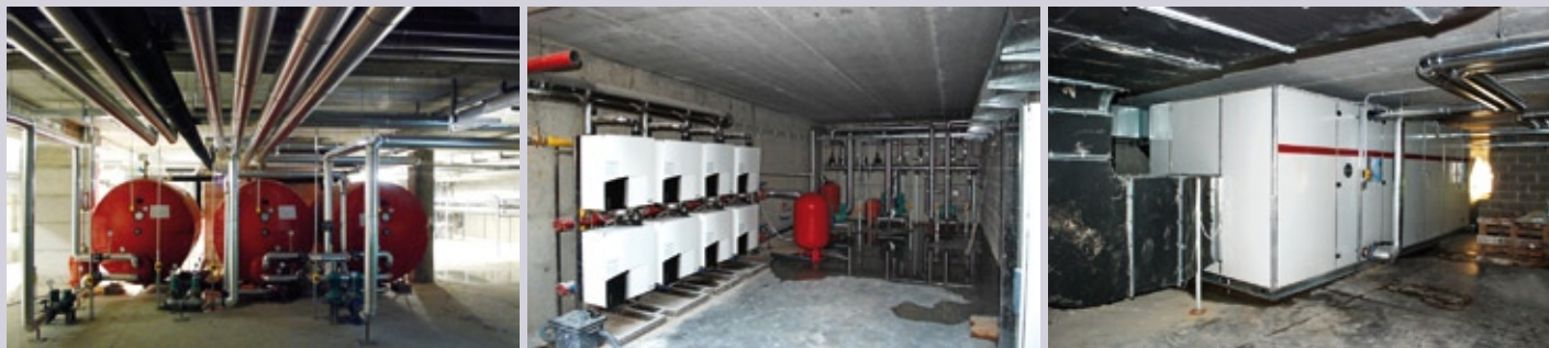
Produzione acqua calda
